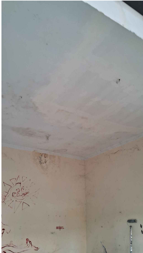
KONDISI PLAFON GEDUNG HMJ YANG PERLU PENGECATAN
