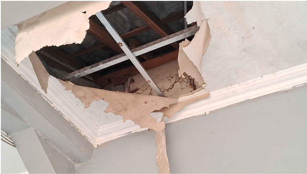
KONDISI PLAFON GEDUNG HMJ YANG RUSAK
